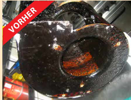
Das Lüftergehäuse in einem desolaten Zustand...
